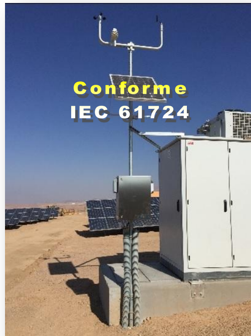
Particolare della stazione meteorologica e del quadro del datalogger – Installazione Giordania
