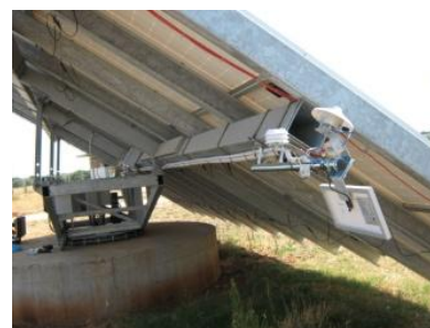
Sensori meteo applicati direttamente sui pannelli fotovoltaici
