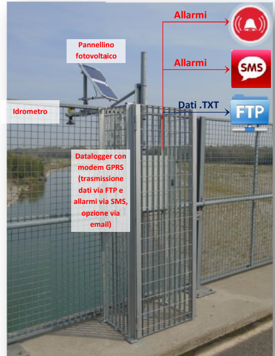
Stazione monitoraggio acque superficiali
