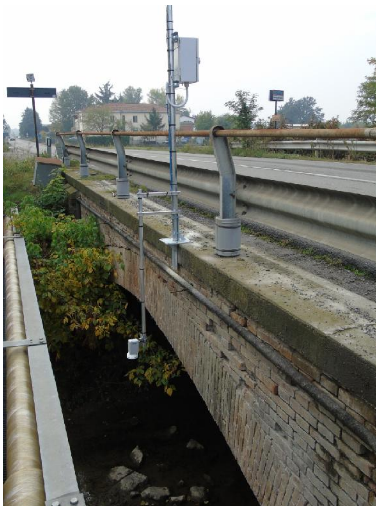
Figura 2 – Esempio di installazione stazione idrometrica con sensore ad ultrasuoni
